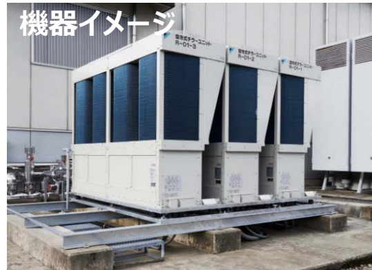
空冷ヒートポンプチラー（電気式）
